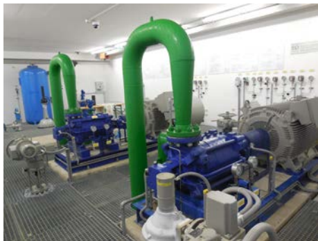
Kombiniertes Pump- und Wasserkraftwerk Grubbach
